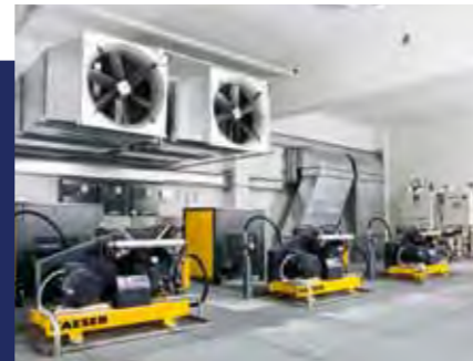
Pogled na visokotlačni dio kompresorske stanice
