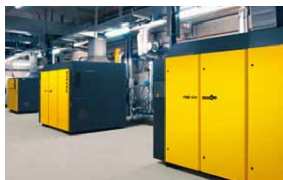
Svjetlo, visoko i prostrano: Pogled na kompresorsku stanicu novog pogona nkt cables
